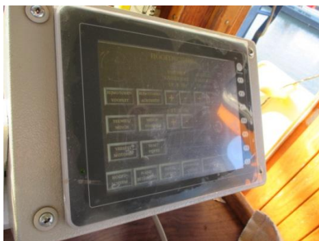
PLC- touchscreens voor verwerkingsmachine
